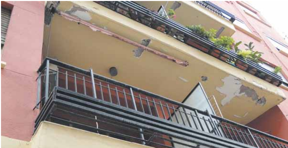
Catas que se están haciendo en las vigas de carga que hay en los balcones
