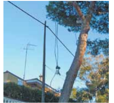
El cable tras su rotura
