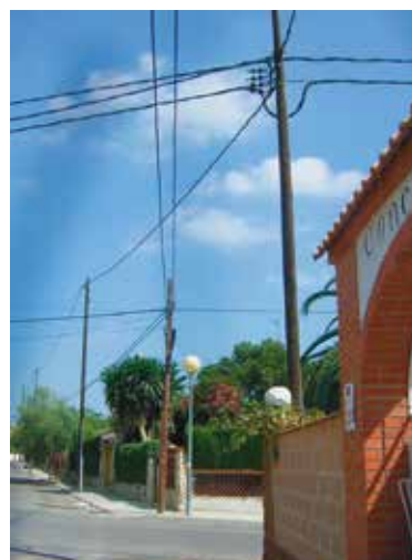
Líneas aéreas en La Canyada
